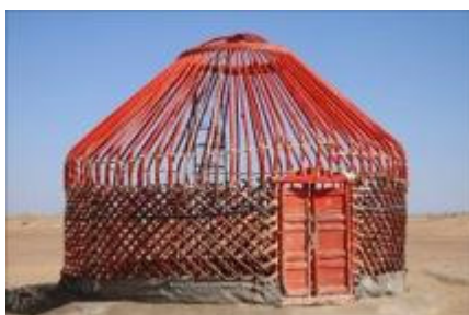
Au cours de la première étape de construction, on installe les “murs” et les montants en bois de la yourte. On installera ensuite la grosse toile de feutre qui isolera la yourte du froid comme du chaud. ©Jean-Pierre Dalbéra from Paris, France via commons wikimedia
